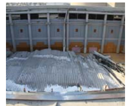
体育館の屋根崩落被害(埼玉県)
