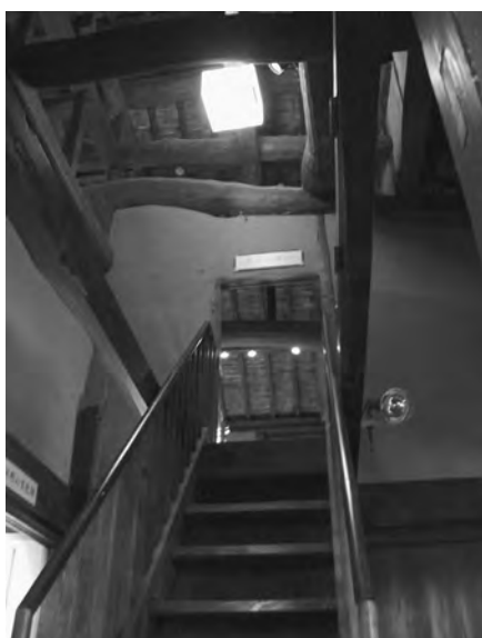
階段は傷みが激しく同様の素材で再生
