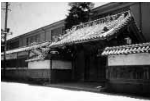
老朽化の進んだ生田門
