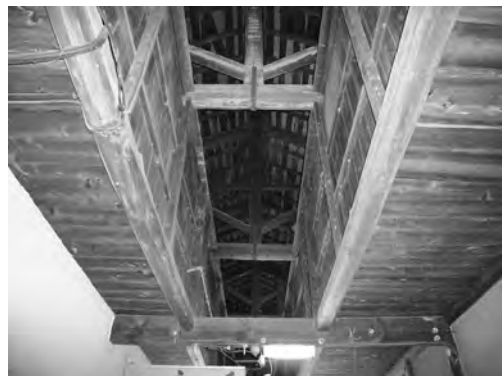
小屋裏換気部分
