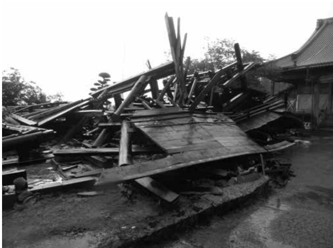
写真1 激しい横揺れに合い 2階床組部で折損倒壊した寺院の山門
