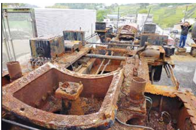
【修理前の状況】
