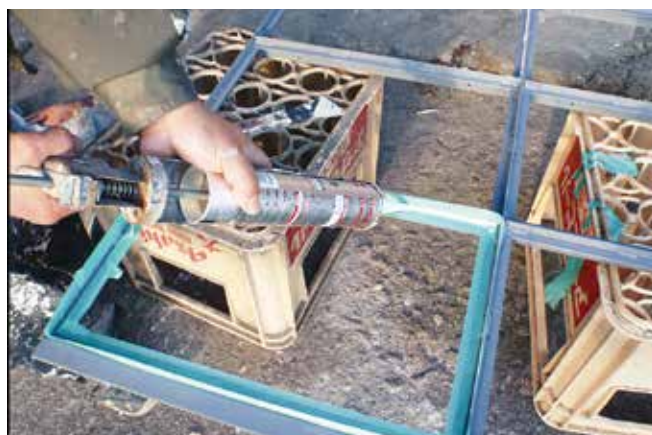
【錆止め塗りの上にコーキング打】
