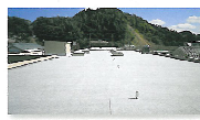
アスファルト防水露出砂付仕上げ 仕様耐用年数 約13年(17~22年)
